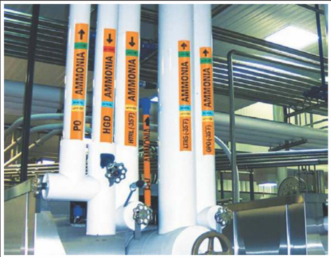
Identificación normalizada de cañerías
